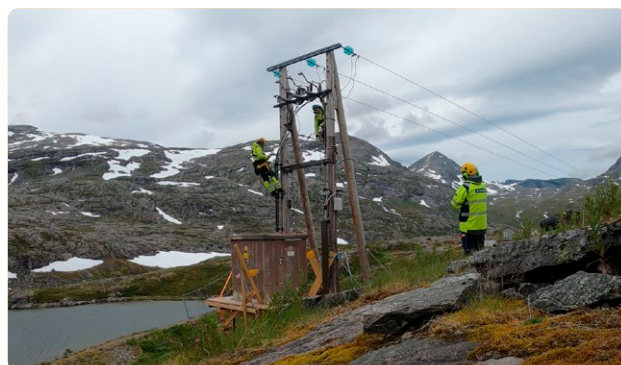
● I løpet av sommeren ble en defekt transformator i Via byttet ut.
